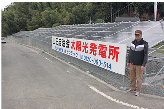
丹波市春日町山王自治会の太陽光発電所
